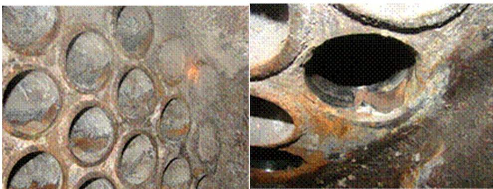
Figura 3. Tubos mal taponados, caldera de biomasa y deformación en la misma
