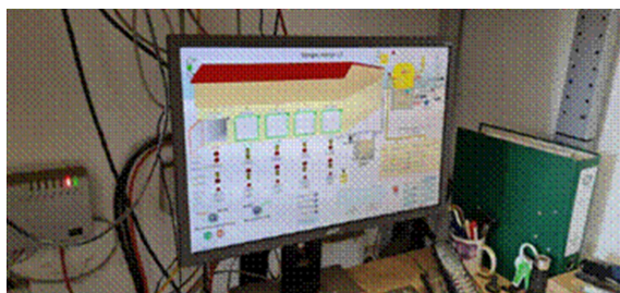
FIGURA 10. Detalles del seguimiento del proceso en cada digestor mediante la sala de control. Fuente: Archivo del autor.
