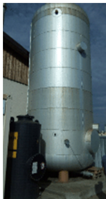
FIGURA 6. Exteriores de la planta, donde se aprecia el tanque para almacenar el excedente del agua caliente generada. Fuente: Archivo del autor.
