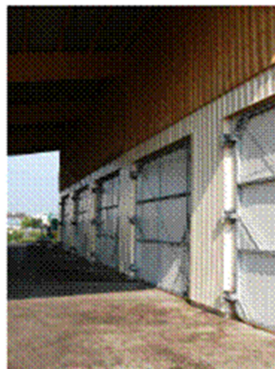
FIGURA 5. Vista exterior de la entrada a los 5 digestores. Fuente: Archivo del autor.
