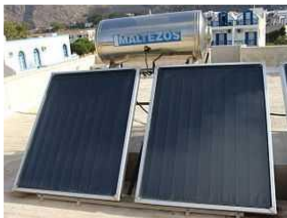
Figura. 1.3. Calentador solar de agua.
