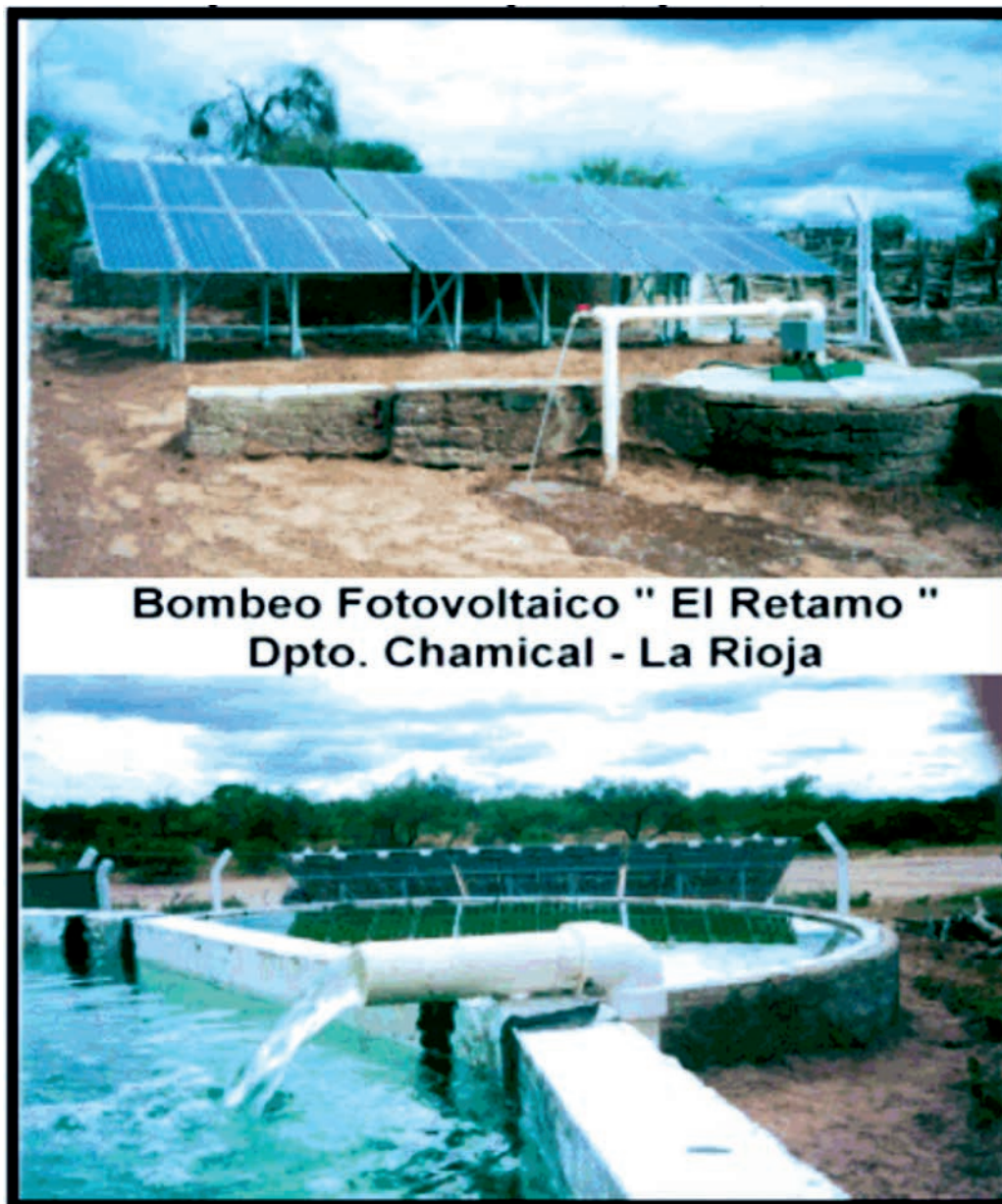
FIGURA 10. Sistemas de Bombeo de Agua Fotovoltaico Región Semiárida de Argentina.
