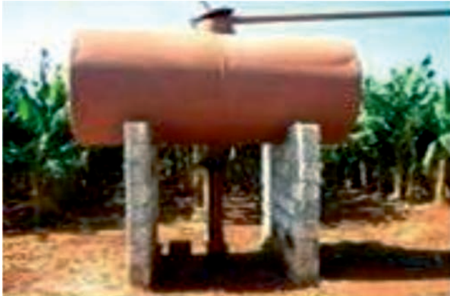
FIGURA 3. Tanque disipador de energía.
